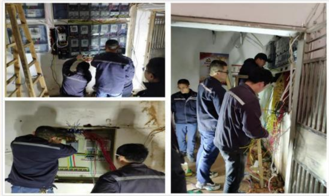
(教工楼电柜电箱智能电控改造)
